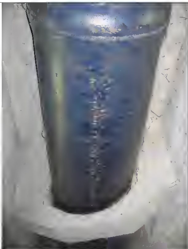
Tubo gas dismesso Ø 600 in ghisa
