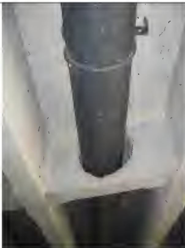
Tubo acquedotto Ø 300 in ghisa
