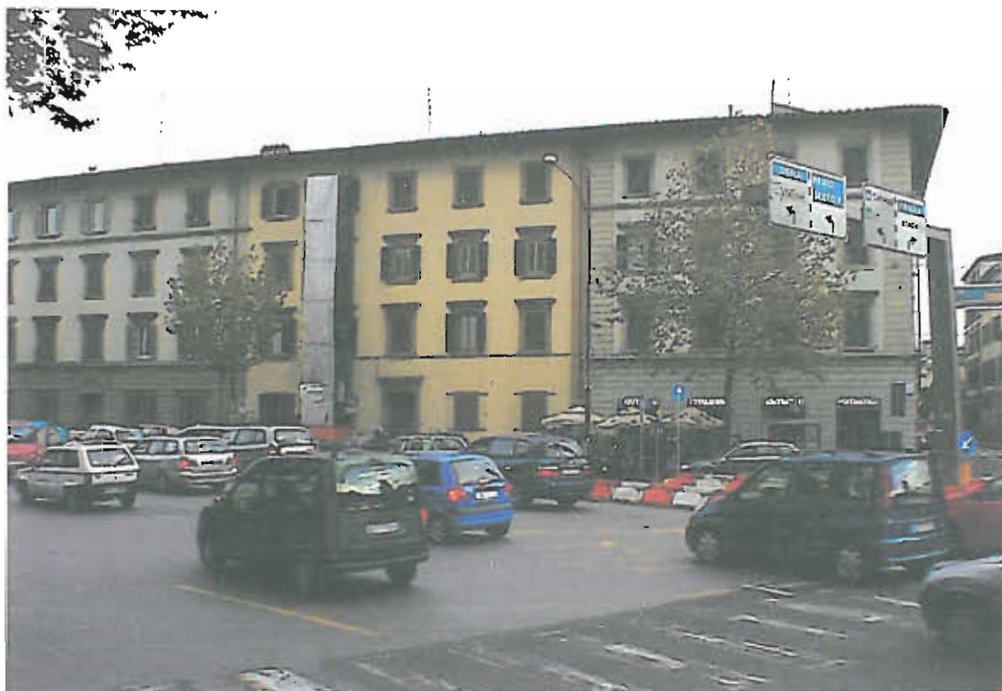
Area prospiciente il pozzo 1 ed il pozzo di aggotamento, insistente su viale Strozzi
