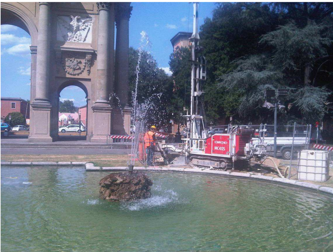
FOTO 6 – Piazza della Libertà – Installazione monitoraggio lungo linea
