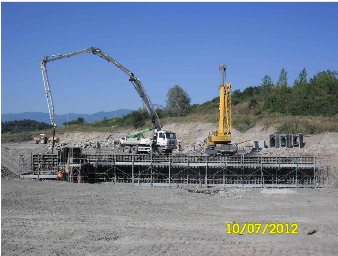
FOTO 2 – Località S.Barbara – Vasca di accumulo impianto di trattamento
