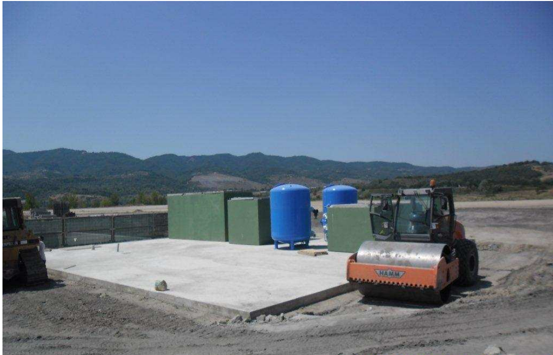
Foto 2 - Località S.Barbara – Impianto di trattamento
