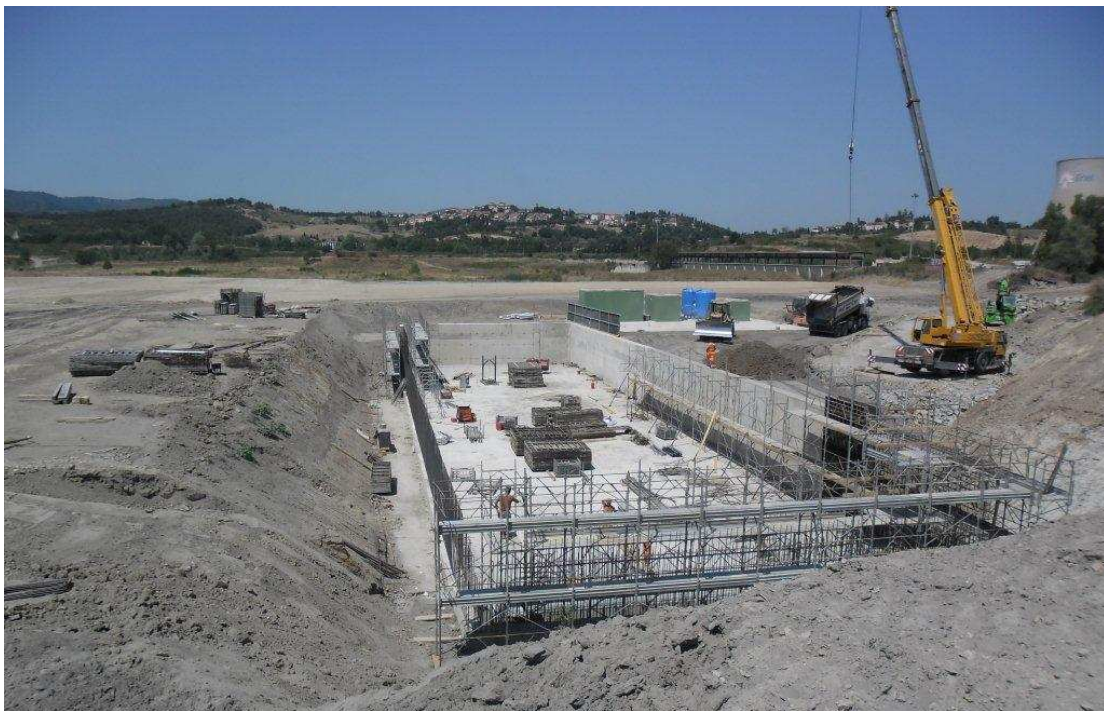
Foto 1 - Località S.Barbara – Vasca di accumulo impianto di trattamento
