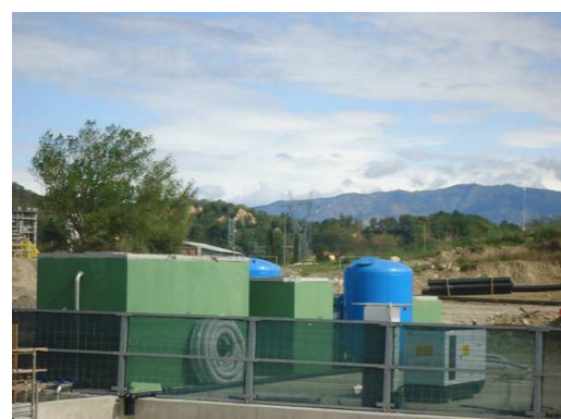
Impianto di trattamento acque
