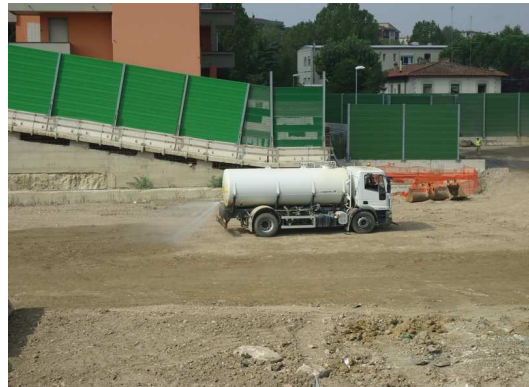
Sistema di bagnatura area cantiere
