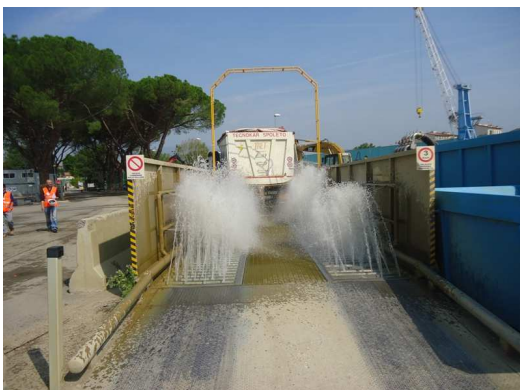
Sistema lavaggio mezzi in uscita
